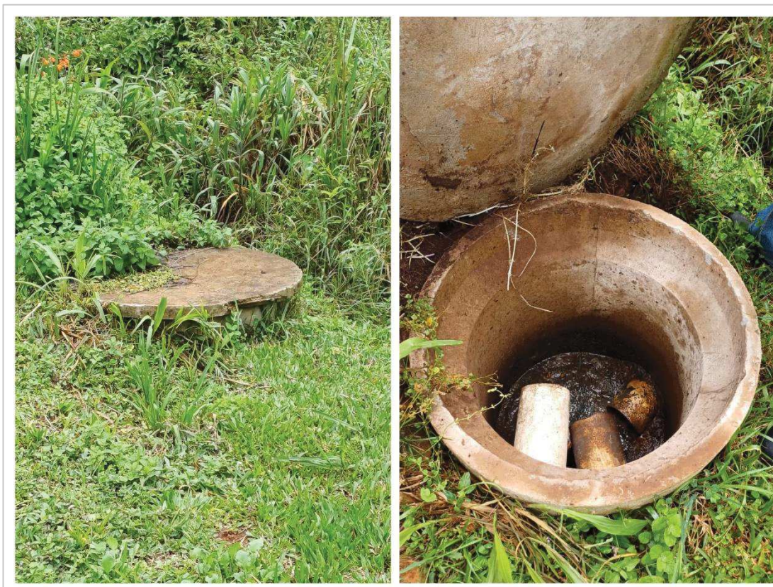
FIGURA 72 – Rede de coleta de esgotos domésticos existente no bairro São Sebastião das Três Orelhas
