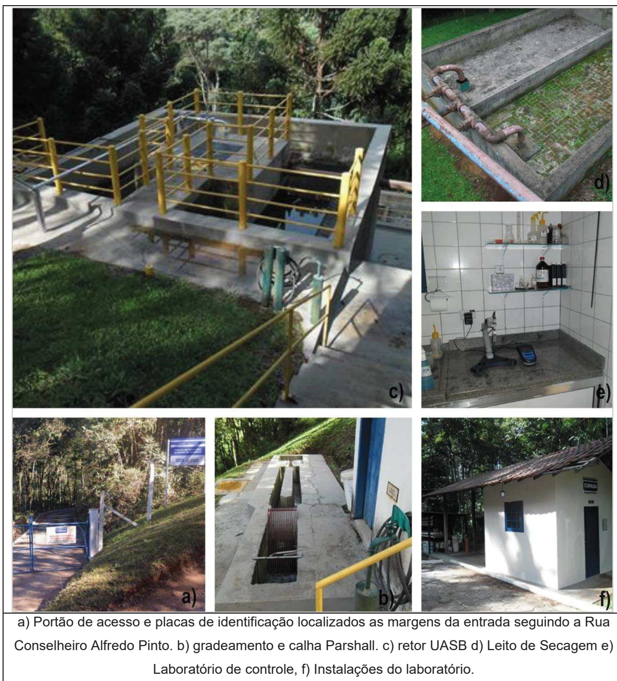
FIGURA 75 - ETE do sistema de esgotamento sanitário do município.
