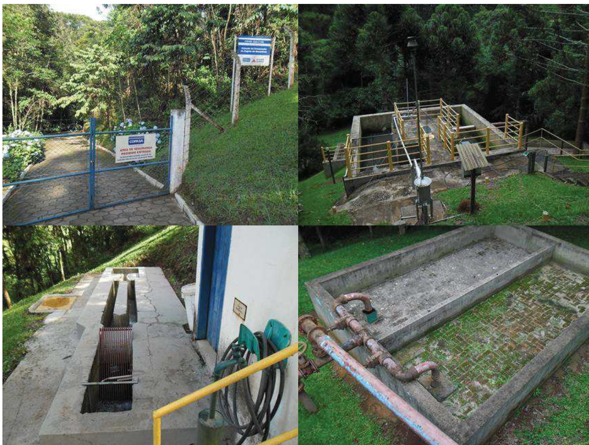
FIGURA 98 – Estação de Tratamento de Esgoto no município de Gonçalves
