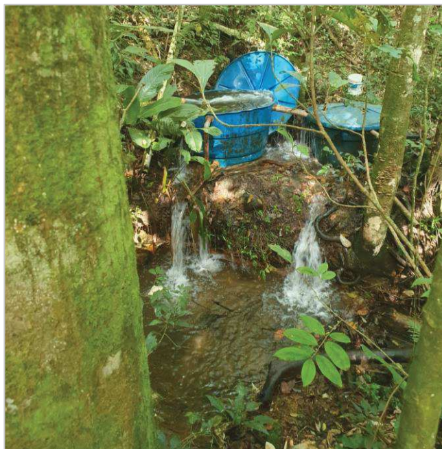
FIGURA 49 – Sistema de abastecimento de água do bairro Córrego da Foice - Captação.
