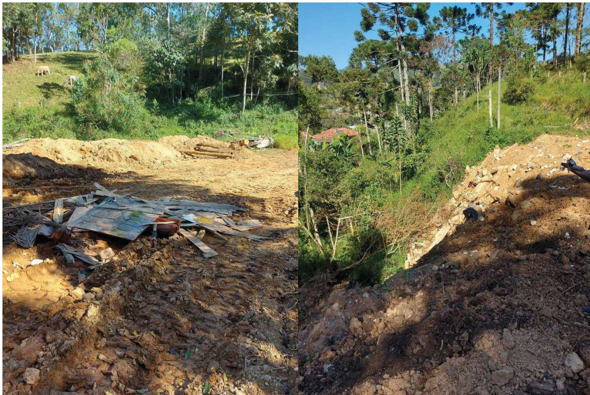
FIGURA 105 – Aterro de entulho
