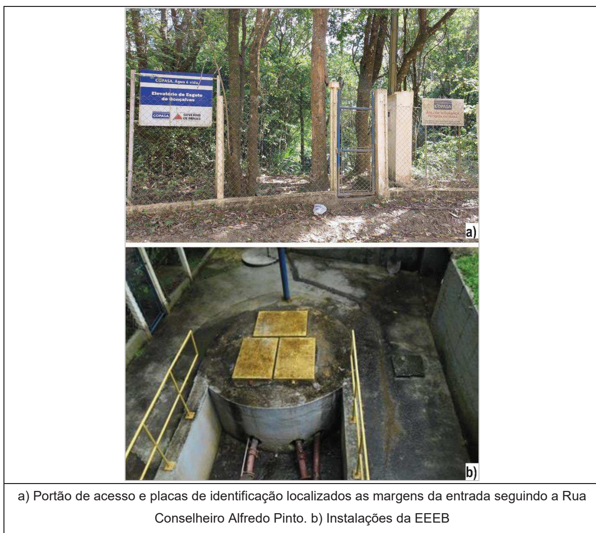
FIGURA 74 – EEEB do sistema de esgotamento sanitário de Gonçalves
