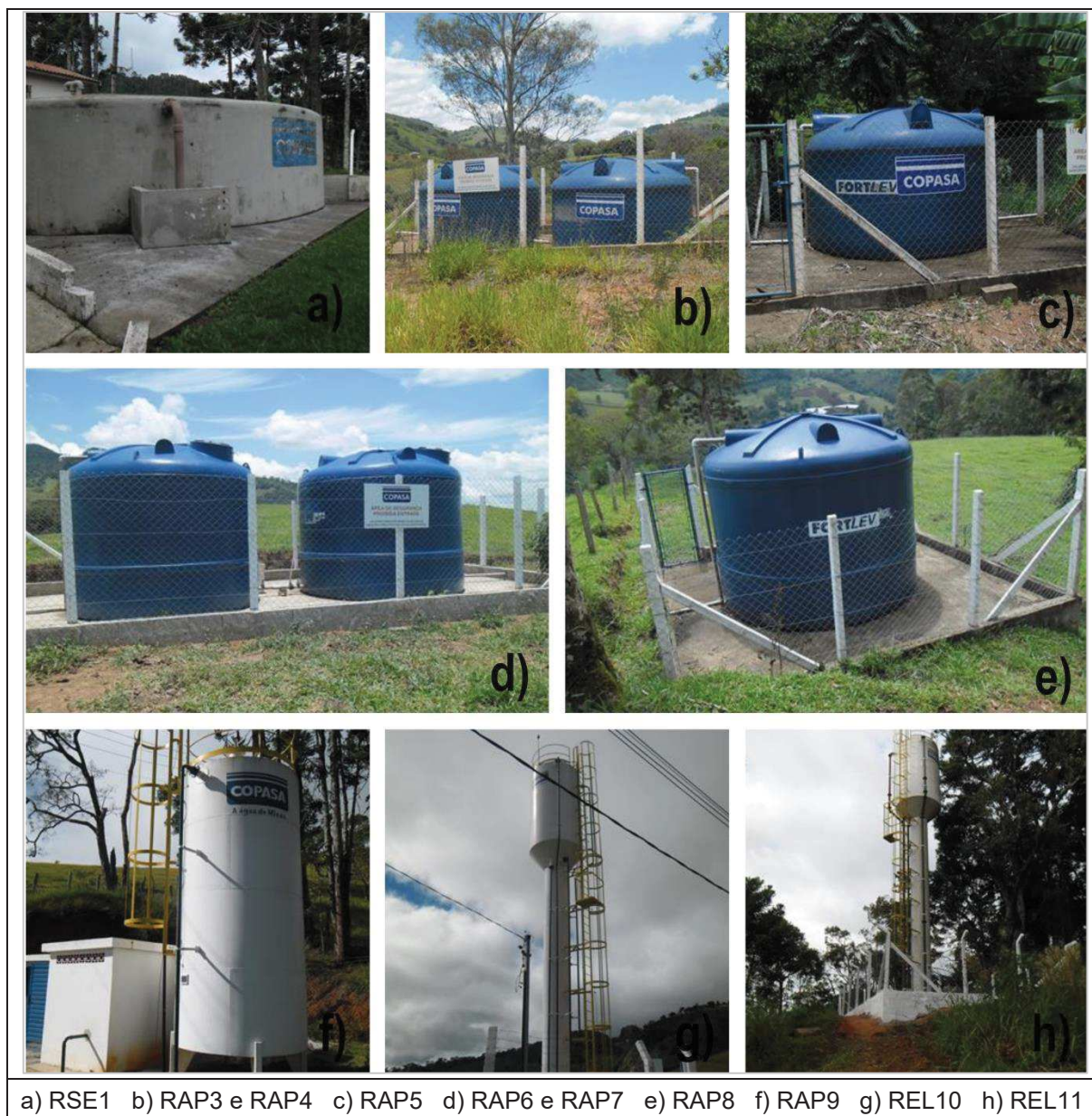
FIGURA 60 - Reservatórios do sistema de abastecimento de água de Gonçalves.
