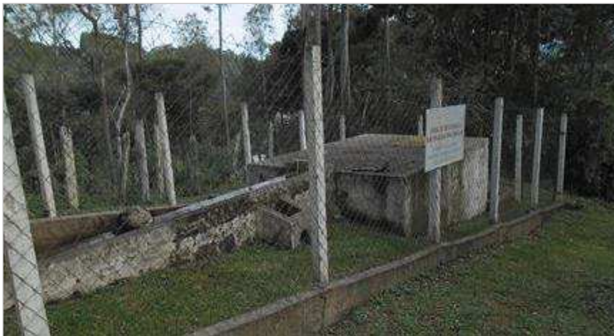
FIGURA 57 – Estação elevatória de água bruta
