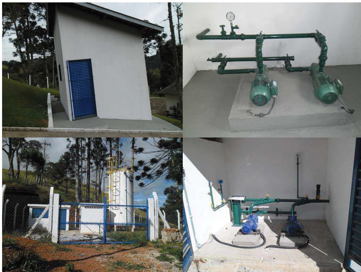
FIGURA 59 – Elevatórias de água tratada no SAA de Gonçalves.
